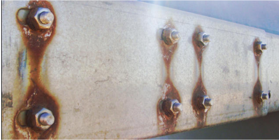
Figura 2. Corrosión Galvánica (source: F4 WAREHOUSE)
