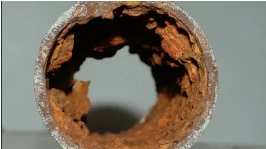
Figura 3. Corrosión Microbiológica (source: INSPENET)
