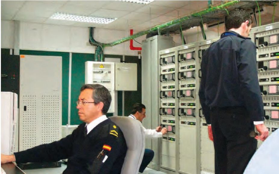
Sala de Receptores en Bermeja.
