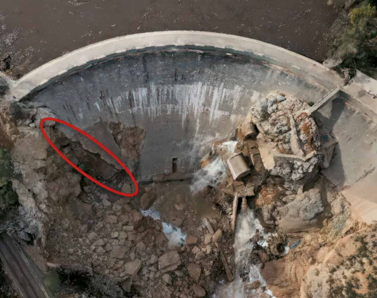
Vista aérea de la presa de Buseo tras la DANA, en la que se aprecia el sector afectado por la fractura detectada mediante datos LiDAR. (Fuente: IHM)
